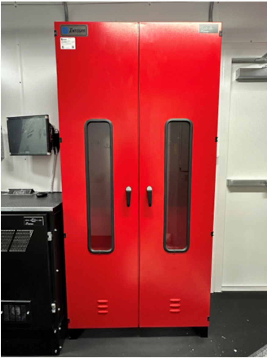
Gabinete Equipo Contra Incendios
