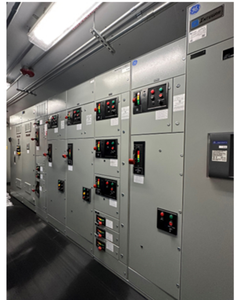
Centro de Control de Motores
