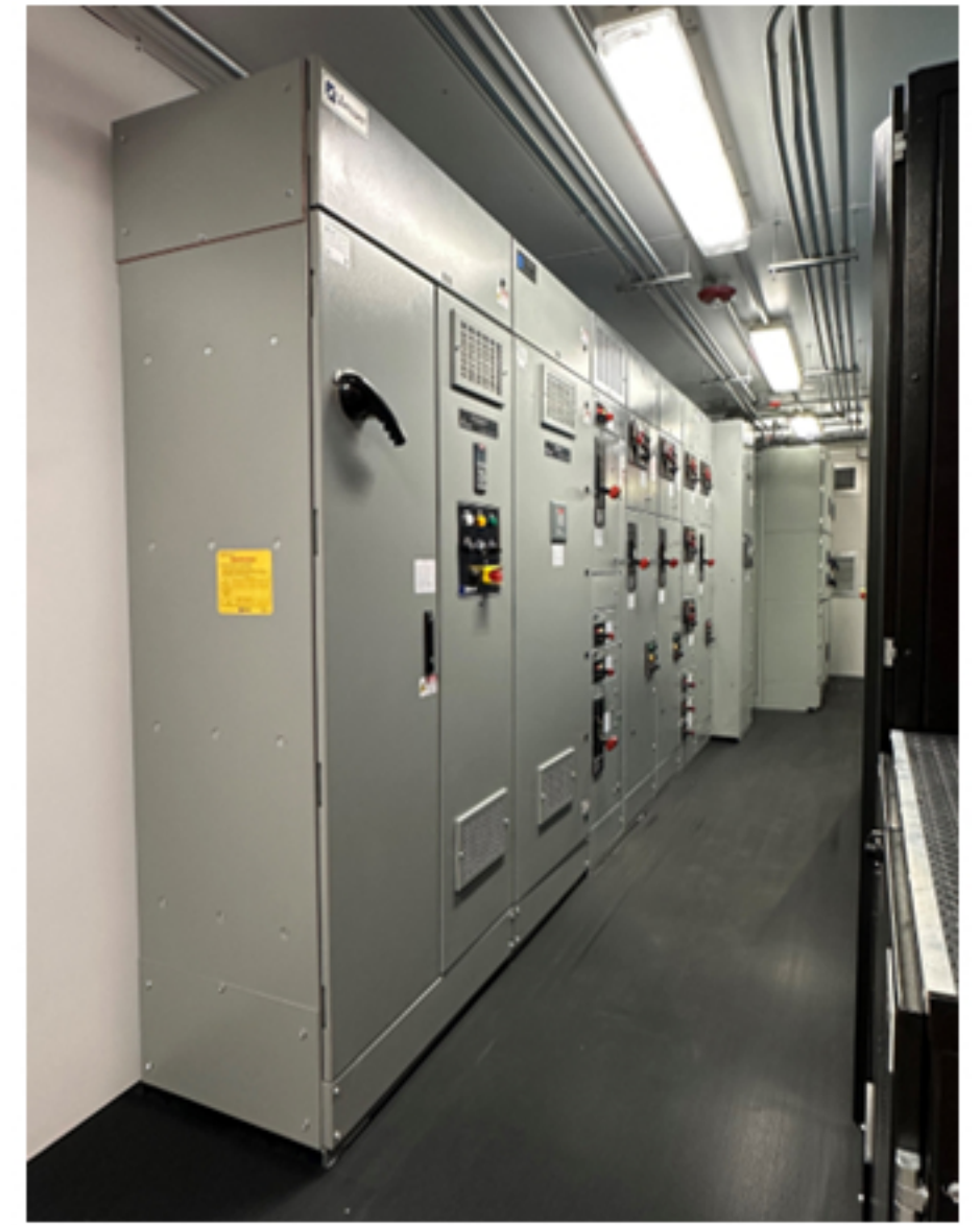
Drives y Centro de Control de Motores
