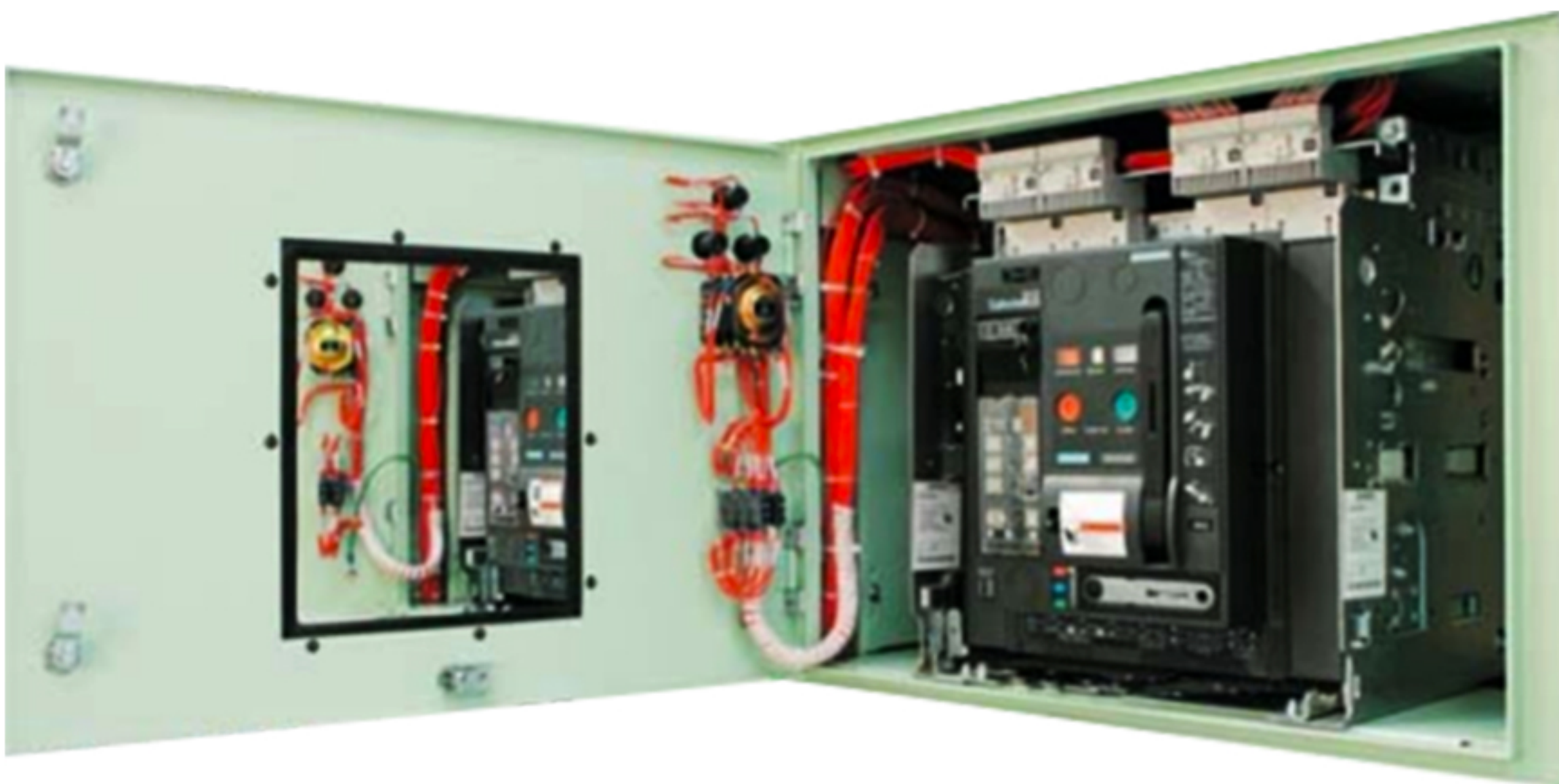
Compartimento del interruptor con acceso frontal.
